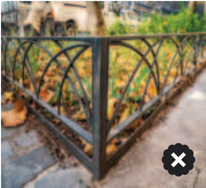
SERRURERIE DE PROTECTION HAUTE AVEC REMPLISSAGE AJOURÉ DÉCORATIF – TYPE DAUMESNIL (avenue Daumesnil - 12°)
