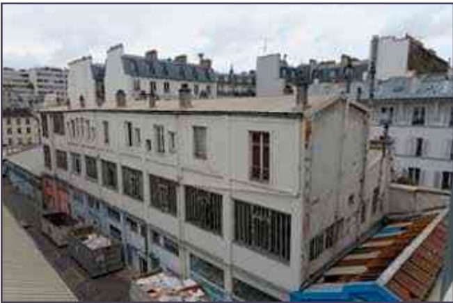
Vue de la façade des ateliers protégés qui ont subi des désordres structurels
