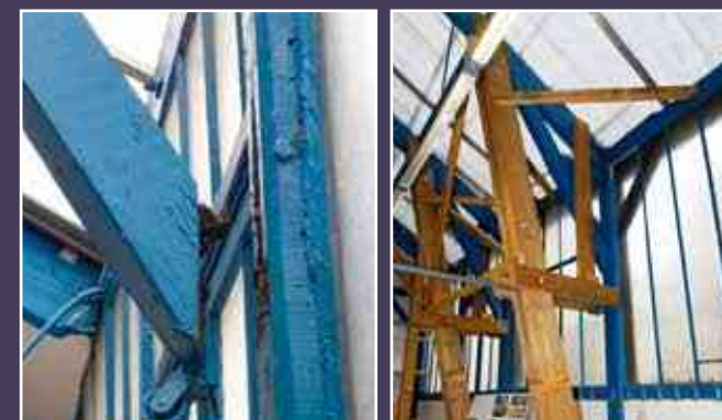
Désordre et étalement des structures.
