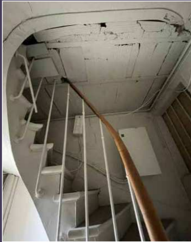
Vue de la dernière volée condamnée de l'escalier de service (© Maison Edouard François, architecte).
